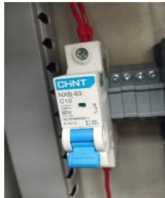
Gambar 2. 8 MCB (Miniature Circuit Breaker) (Sumber: Dok. Pribadi, 2024)
