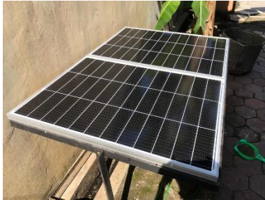
Gambar (f) Kondisi Panel Surya Setelah Dibersihkan
