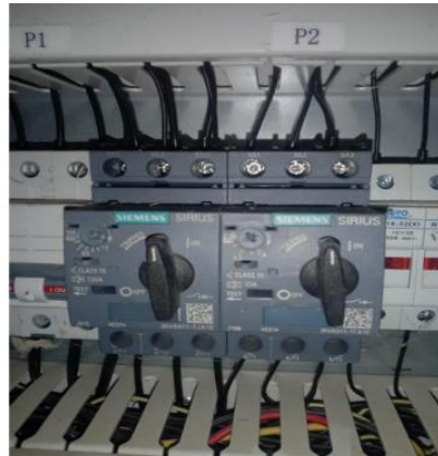
Gambar 2.5 Motor Protection Circuit Breaker (MPCB) pada Mesin WSB
