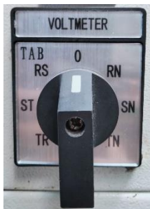
Gambar 2. 20 Selektor Volt meter Sumber: dok priadi
