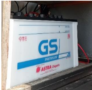
Gambar 2. 8 Akumulator/baterai (Sumber: Dok. Pribadi, 2023)
