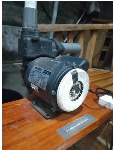
Gambar 2. 7 Pompa Air (Sumber: Dok. Pribadi, 2023)
