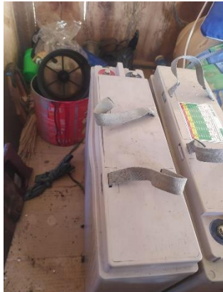
Gambar 1. 1 Kondisi Baterai Sumber: Dok. Pribadi 2023
