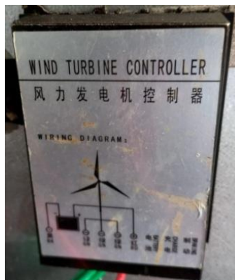
Gambar 2.9 Wind Turbine Controller (Sumber : Dok. Pribadi, 2023)
