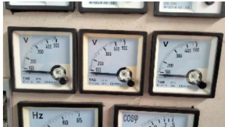
Gambar 2.3 Voltmeter Sumber : Dokumen Pribadi
