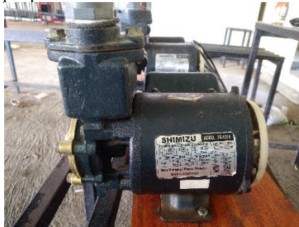
Gambar 2. 12 Pompa Air (Sumber : Dok. Pribadi, 2023)
