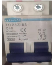
Gambar 2. 6 Miniature Circuit Breaker (MCB) DC (Sumber : Dok. Pribadi, 2023)
