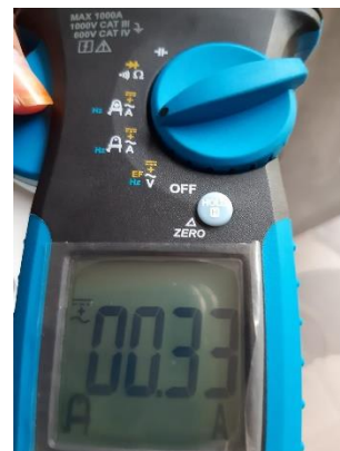
(Pengukuran Daya Listrik Motoran Penggerak Cutting )
