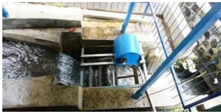
Gambar 2.1 Instalasi PLTPH (Albab, 2020)
