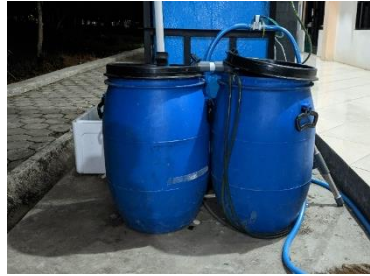
Tangki Penampungan Air
